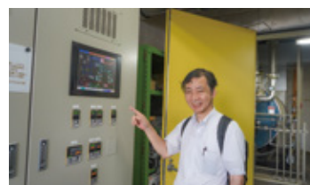
システム全体を統括する制御盤
