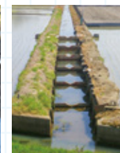
排水路ごとに水位を階段状に上げていきます
