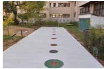
写真上:車いす対応型を含む5基で構築 写真左:「わかりやすさ」を考慮したカラーふたで構築
