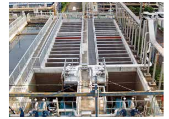
高速ろ過施設(磯ノ上下水処理場)
