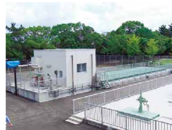
高速ろ過施設
