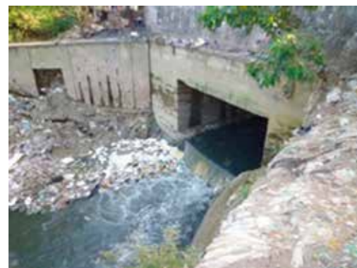
現地雨水排水路の状況 (雑排水が直接川に放流されている)
