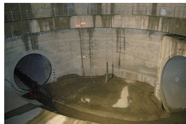
寝屋川南部地下河川(若江立坑内部)、左の下水道増補幹線から右の地下河川へ流入する
