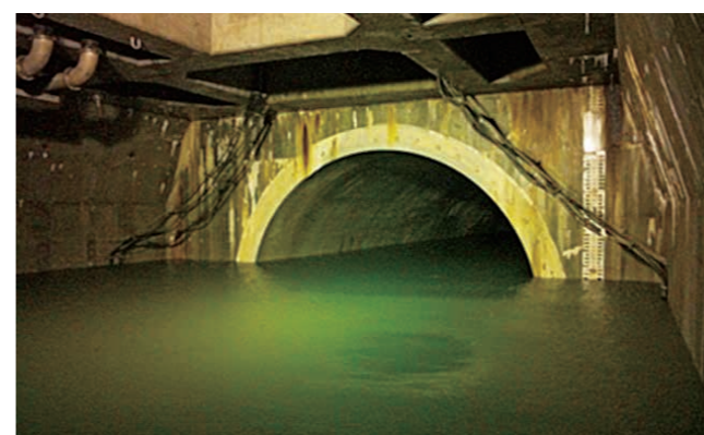
直径9.5mの地下河川に雨水を貯留している状況。平成23年8月、寝屋川南部地下河川(今川立坑)
