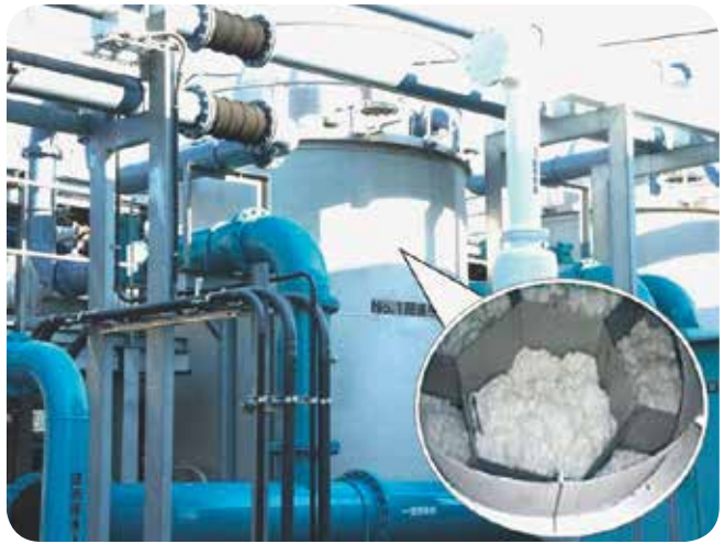
急速ろ過施設
