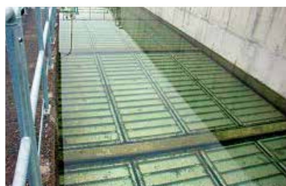
高速ろ過施設
