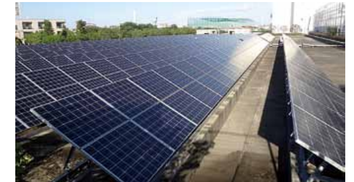
太陽光発電設備(十八条下水処理場)
