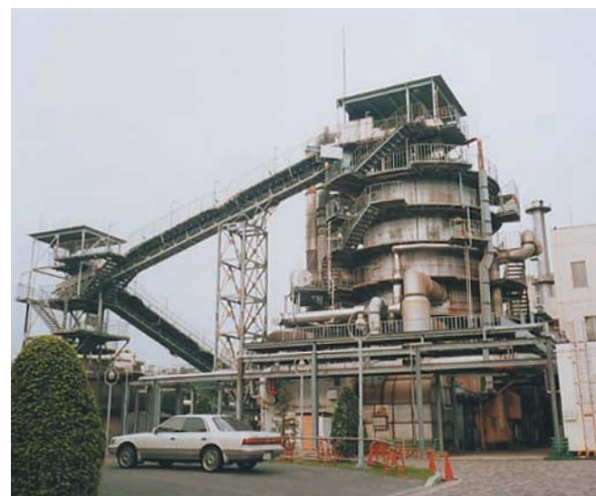
汚泥焼却施設(平野下水処理場)
