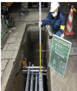
電線共同溝整備支援
